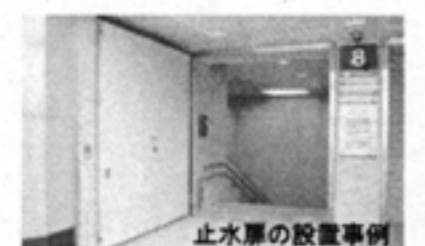
止水扉の設置事例
